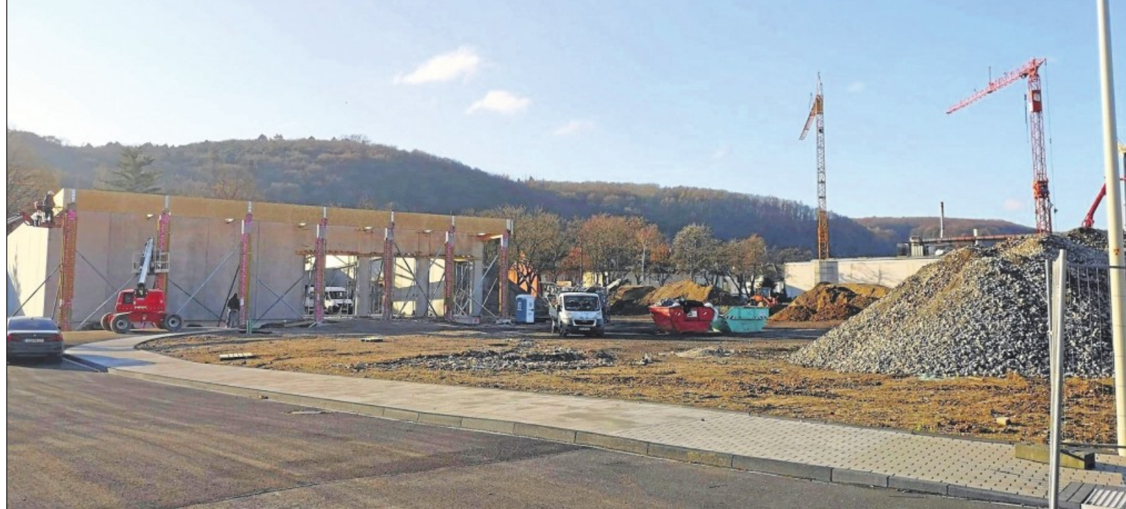
Der neue Haribo-Shop an der Friesdorfer Straße nimmt bereits sichtbare Formen an.
